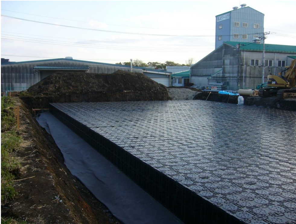
【写真 - 10 : 地下部利用 (プラスチック製 雨水貯留浸透槽 シンシンプロック)】
